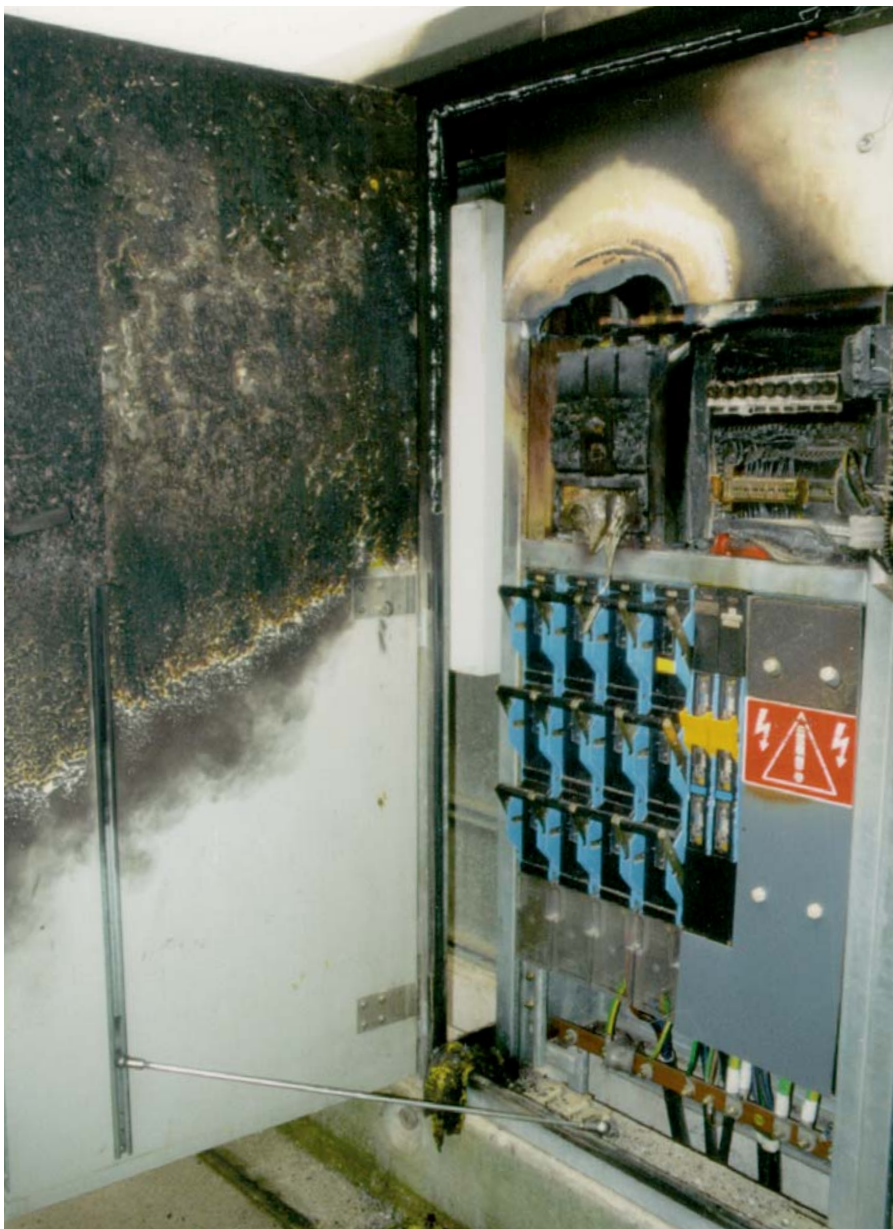
Bild 1 Zerstörungen nach einem Störlichtbogenunfall
