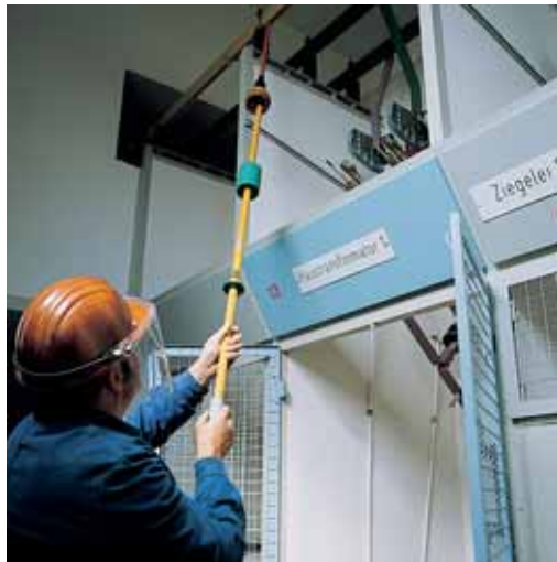
Feststellen der Spannungsfreiheit an einer Sammelschiene einer Mittelspannungsanlage
