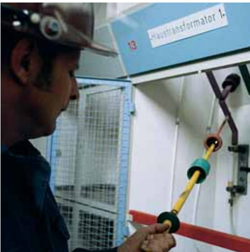
In Schaltzellen kann nur ein normgerechter Spannungsprüfer eine eindeutige Aussage über den Spannungszustand geben
