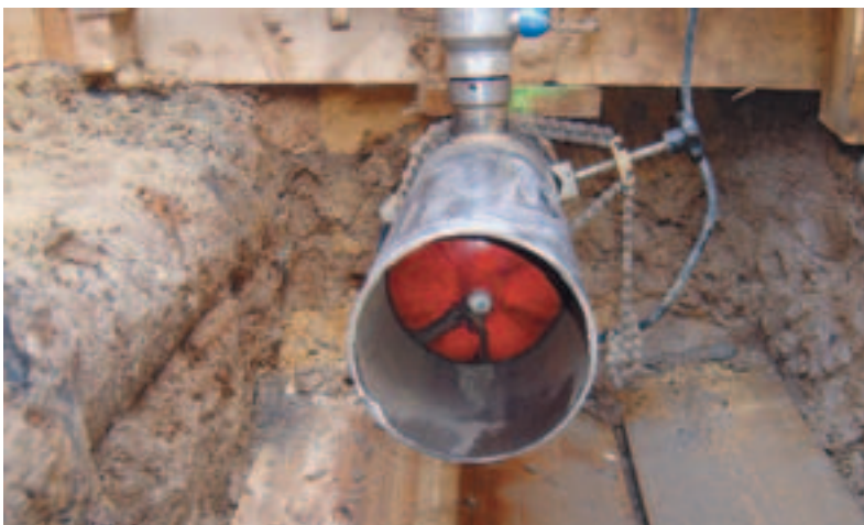
In der Gasleitung gesetzte Absperriblese
