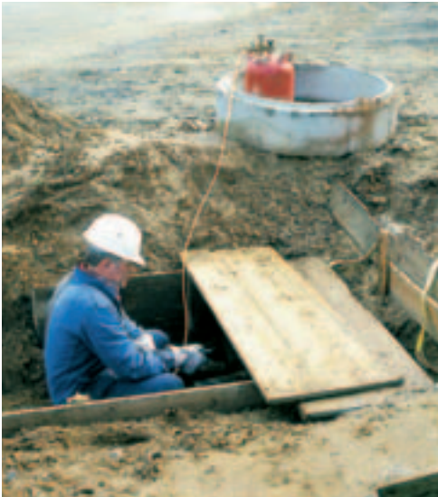
Umgang mit Flüssiggas in einer Baugrube
