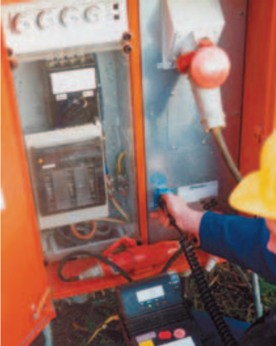
Vorschriftsmäßiger Baustellenspeisepunkt (Baustromverteiler)
